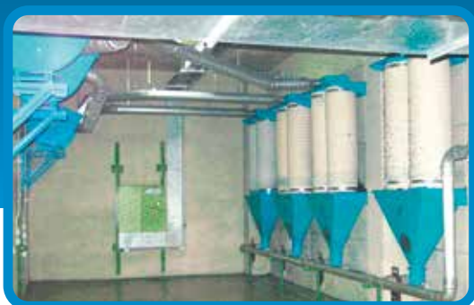
Raccolta di cascami dei collettori di polvere negli impianti di climatizzazione d'aria
