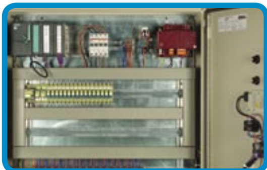
Comandos padrão da unidade para sistemas simples e comandos centrais para sistemas complexos de recuperação de resíduos
