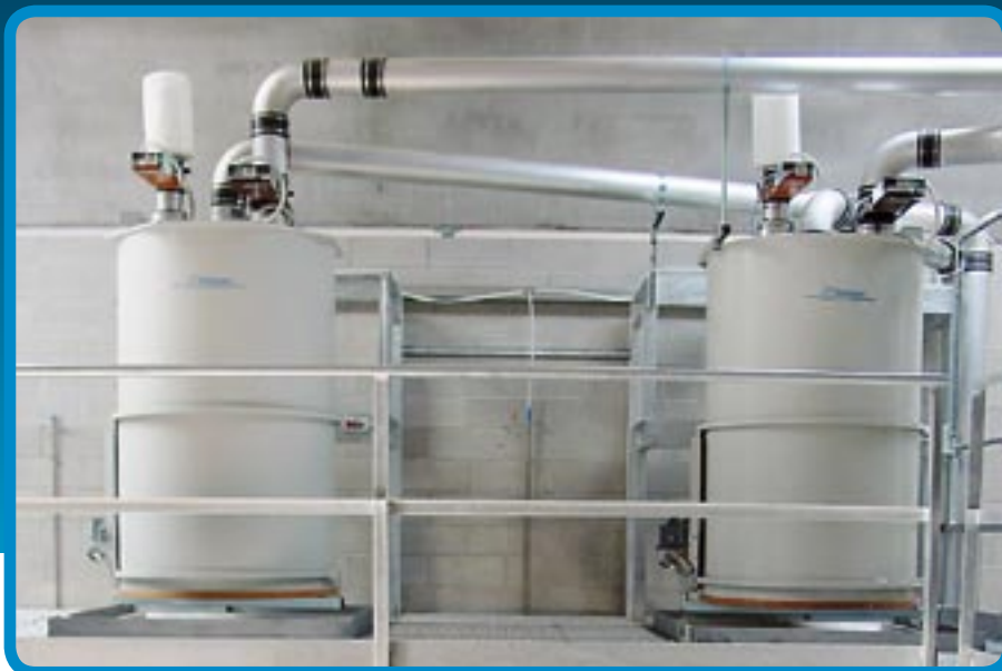
Filtros gêmeos montados em um andaime. O sistema hermético encapsula os resíduos da aspiração à compactação
